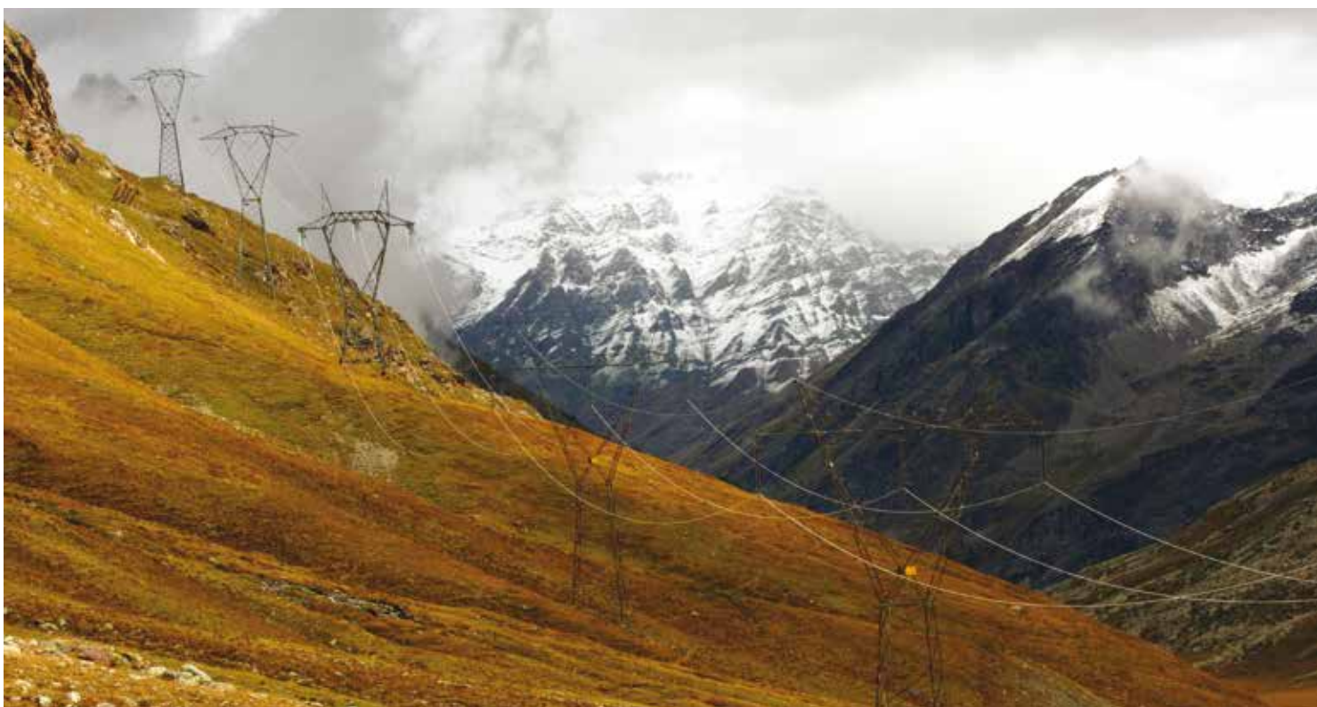
Foto 2.08 Tralici elettrici Fonte ISPRA Paolo Orlandi
