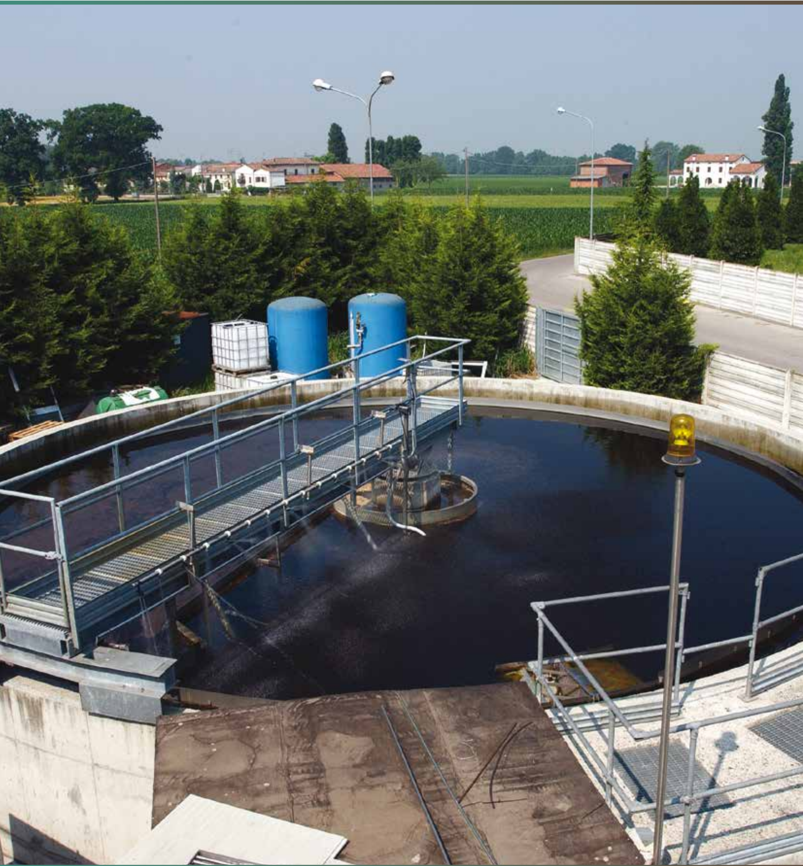
Foto 5.12 Sedimentatore con carroponte Fonte ISPRA Paola Orlandi
